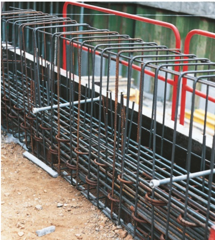
Bauzustand: Bügel- und Spaltzugbewehrung sichtbar.
